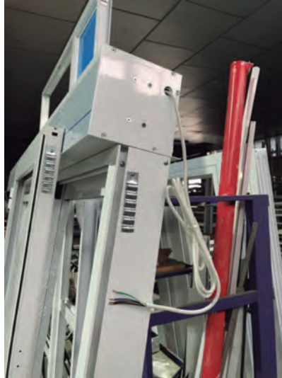
Figura 72. Salida del cableado del motor
